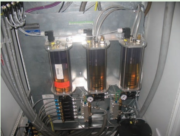
6 Pumpen für Außenschmierung 4 Pumpen für Innenschmierung
