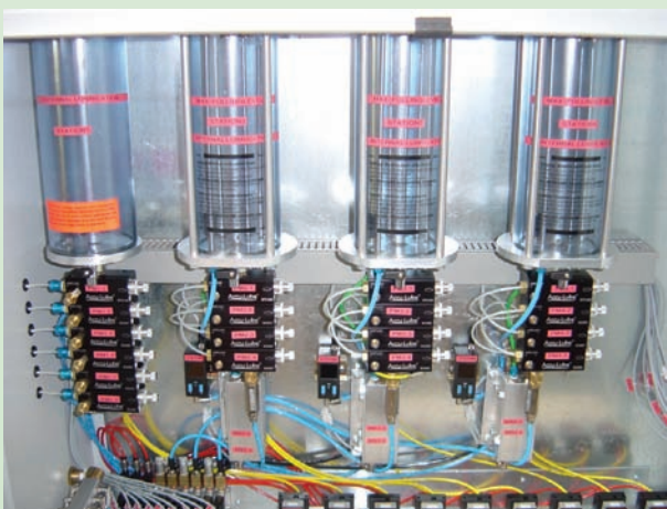
6 Pumpen für Außenschmierung 6 Pumpen für Innenschmierung 6 Pumpen für Zusatzschmierung
