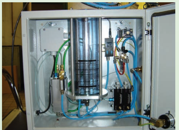
2 Pumpen für Innenschmierung
