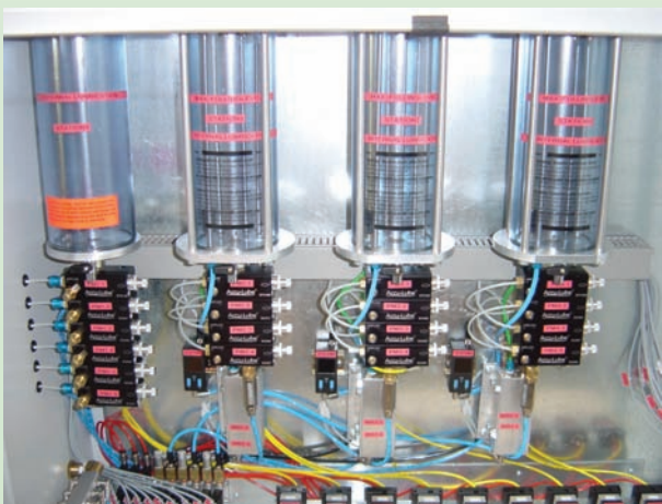
6 pompes pour la lubrification externe 6 pompes pour la lubrification interne 6 pompes pour la lubrification supplémentaire
