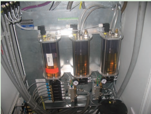
6 pompes pour la lubrification externe 4 pompes pour la lubrification interne
