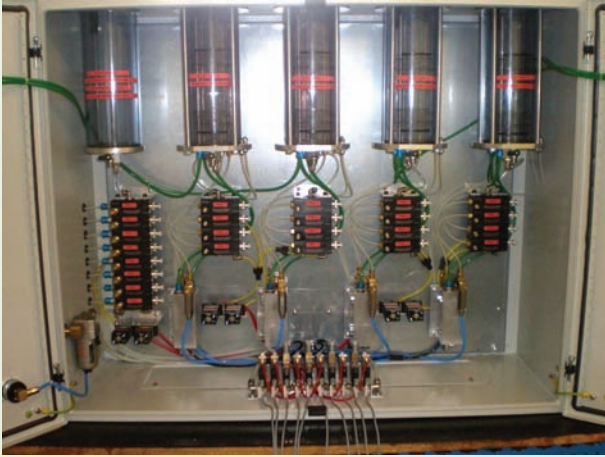
8 pompes pour la lubrification externe 8 pompes pour la lubrification interne 8 pompes pour la lubrification supplémentaire
